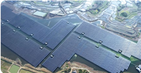
新能公司湖南龚家坪 10 万千瓦光伏项目
