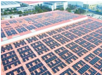
江汽屋顶光伏项目
